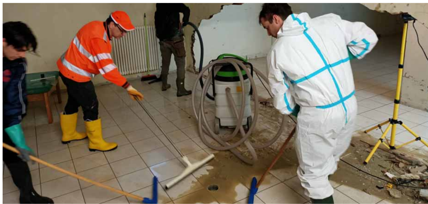
Volontari al lavoro in Emilia Romagna con i macchinari messi a disposizione dalla rete Caritas, anche grazie alle tante donazioni arrivate
