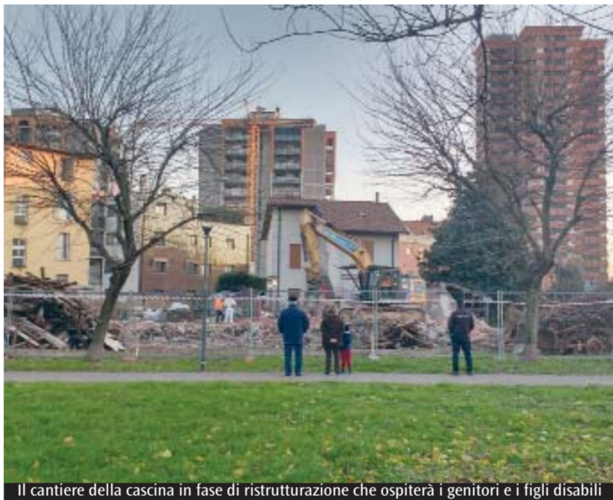
Il cantiere della cascina in fase di ristrutturazione che ospiterà i genitori e i figli disabili
